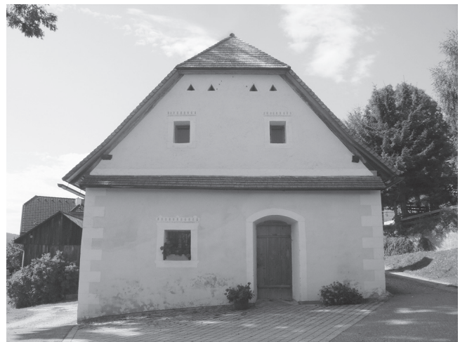
Abb. 4: Die „Fux-Keusche“ im Ort Pack. Im oberen Bereich des Giebelmauerwerkes konnten im Zuge der Renovierung des Gebäudes eine größere Anzahl von Gewehrkeuleinschüssen festgestellt werden (Foto: E. Lasnik, 2009)
